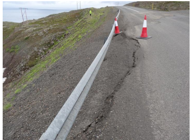
Mynd 4.2 Skemmdir á Siglufjarðarvegi við Skarðsveg.
